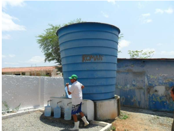
Figura 3.4 - Tanque de armazenamento de água dessalinizada
