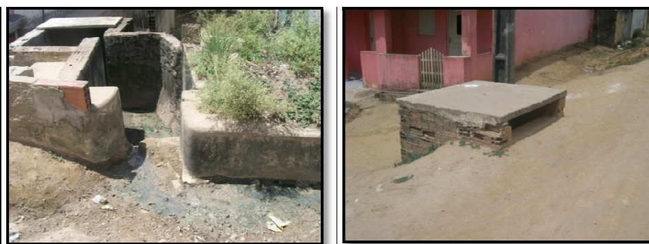
Foto 6 e 7: bifurcações para conter a água da chuva e o esgoto.
