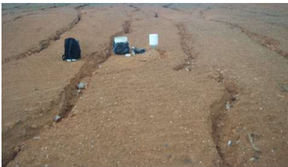
Figura 13 – Processo erosivo no aterro.
