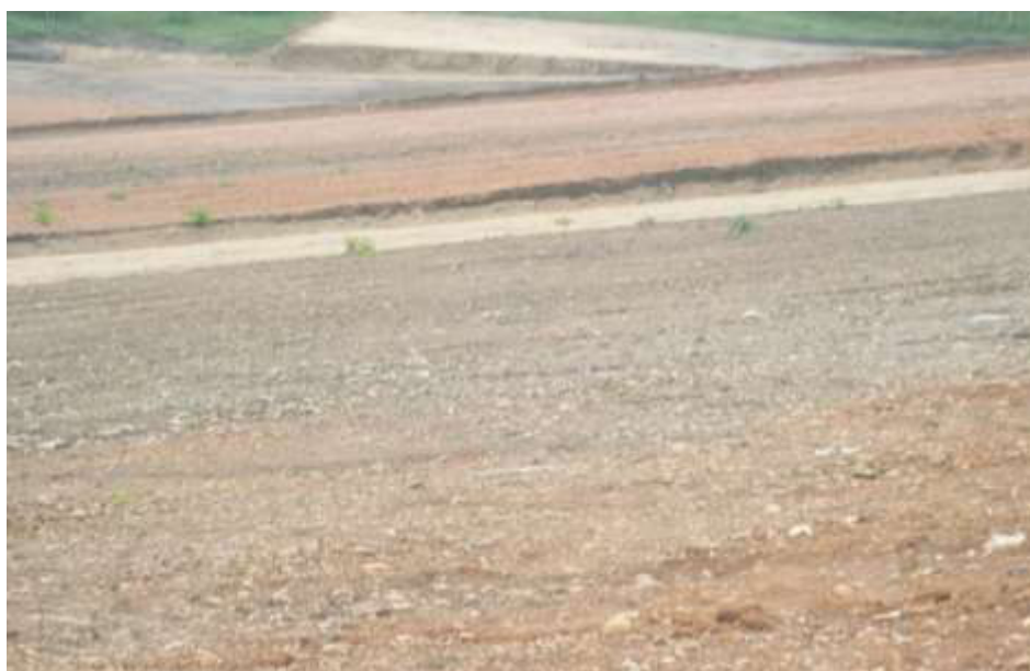
Figura 8: Áreas de aterro com declividades acentuadas.
