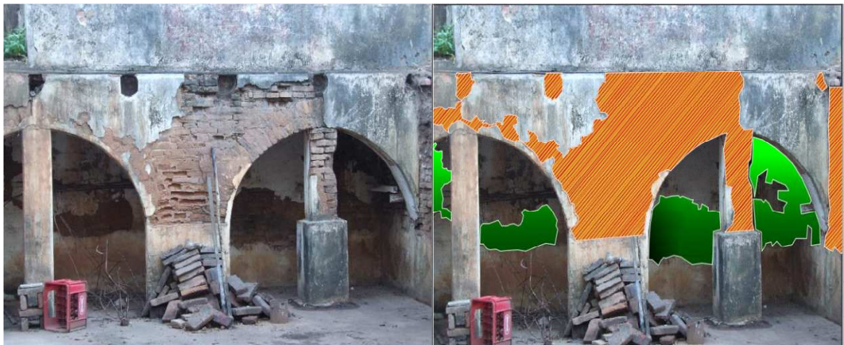
Figura 11: a) Degradação quase total da alvenaria externa. b) Mapeamento das manifestações patológicas com auxílio do Auto-Cad.
