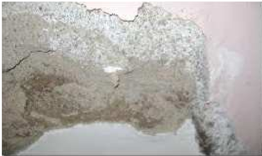
Figura 04 - Desagregação do concreto.
