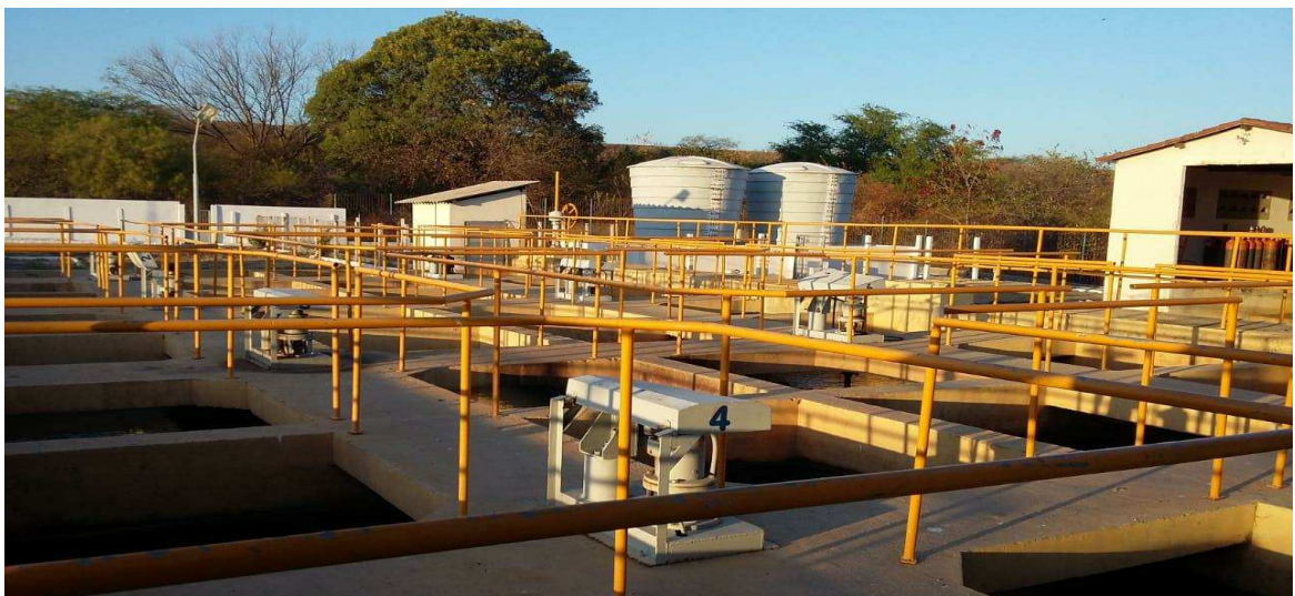
Figura 9: Floculadores da ETA, Patos.
