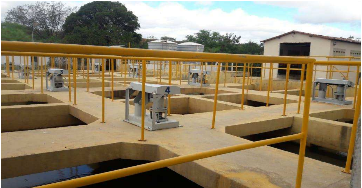
Figura 16: Motores de flocculador
