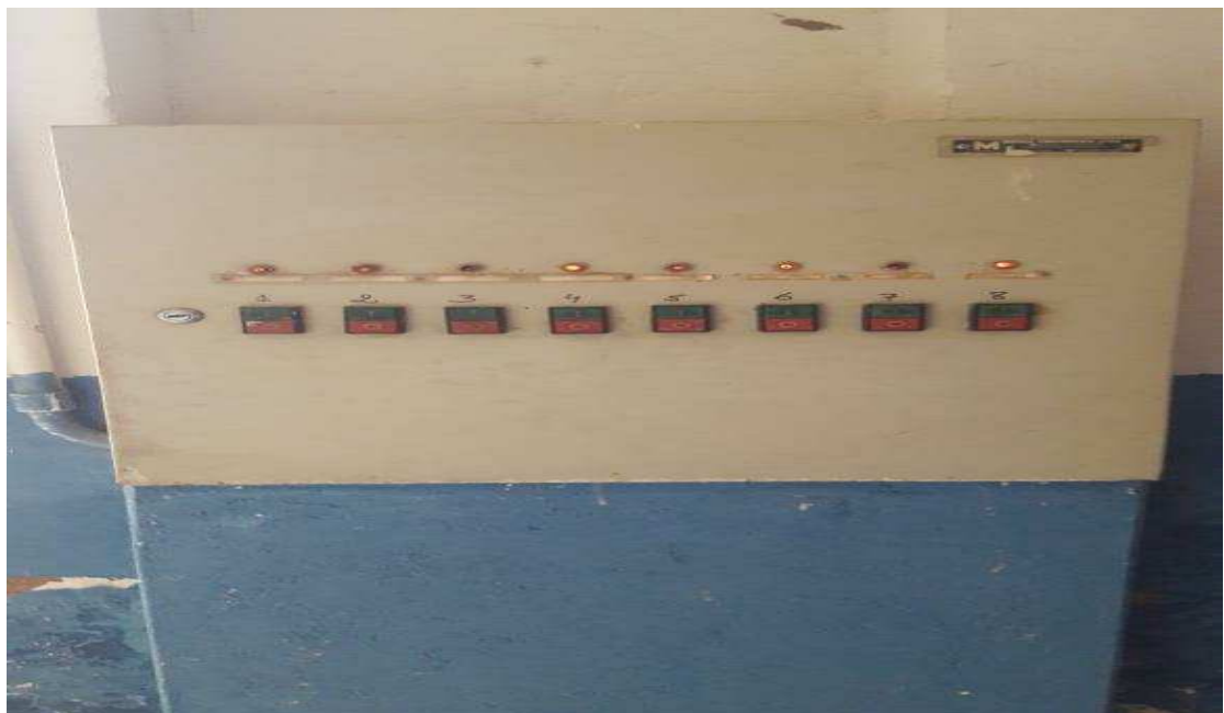
Figura 15: Botoneiras de quadro elétrico
