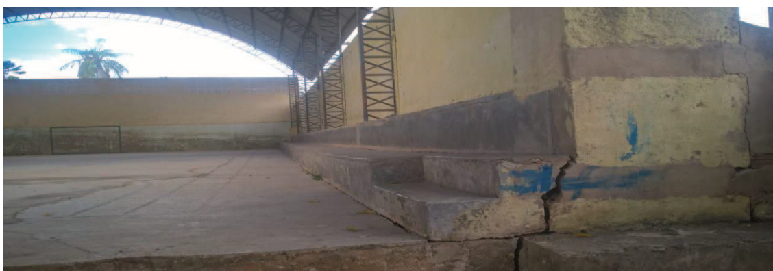
Foto 2 e 3. Tirada pela gestora e cedido ao autor em 19 de dezembro de 2017. Imagem da quadra esportiva interditada
