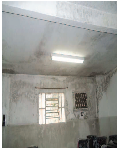
Fig. 4 Sala de informática e leitura com infiltrações
