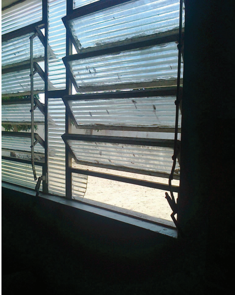
Fig. 1 Janela com vidro danificado
