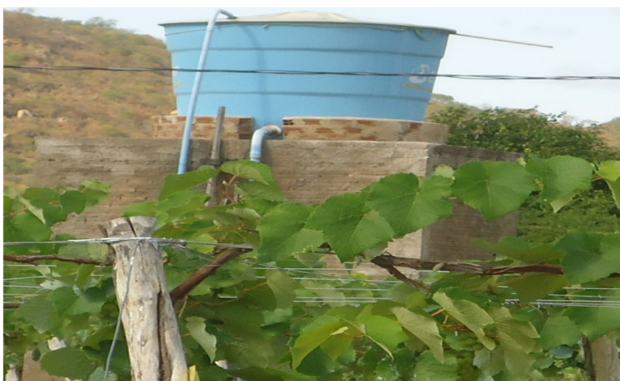
Figura 3. Caixa de distribuição, utilizando-se energia gravitacional, Estação Experimental Agroecológica, Campus IV da UEPB, Catolé do Rocha-PB.
