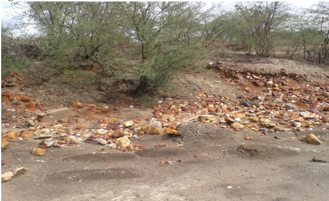
Figura 7. Processo de erosão intenso.
