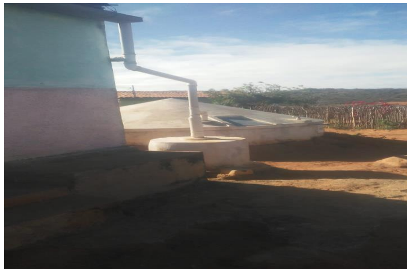
Figura 2 – Cisterna usada para a captação de água da chuva
