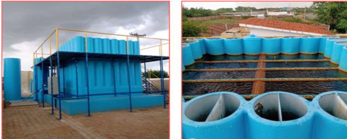
Figuras 11 e 12: Estação Tratamento de Água (ETA) compacta em funcionamento, administrada pela CAGEPA (Companhia de Água e Esgoto da Paraíba)
