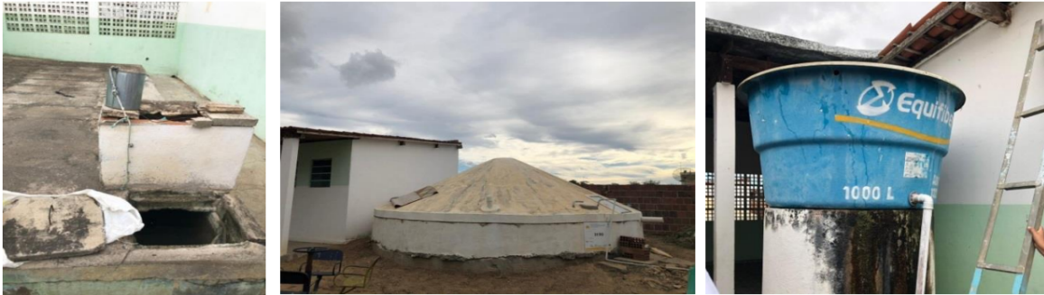
Figura 3 – Visão das cisternas e caixa d'água da escola municipal de Alcantil - PB.
