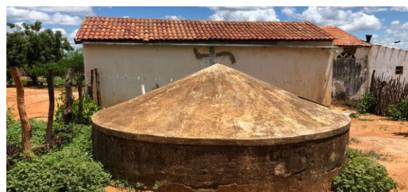
Figura 10 - Cisterna sem manutenção
