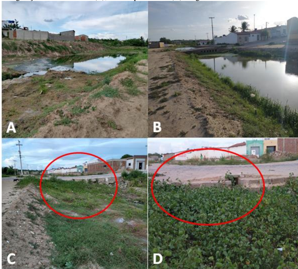
Figura 11: Ruas construídas muito próximas ao leito do rio (A e B); Bueiros pequenos e praticamente obstruídos por vegetação. Visão distante (C), Visão aproximada (D). Registro efetuado em Abril de 2022.
