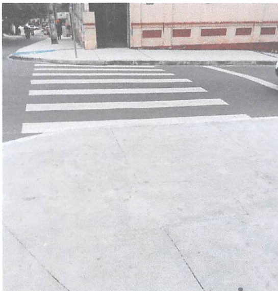
Figura 8: Reforma nas calçadas do centro de Campina Grande/PB, cruzamento da Rua Cel. João Lourenço Porto. Obs. Falta de sinalização e rebaixamento da calçada para via.
