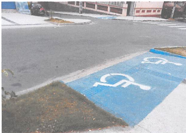
Figura 9: Reforma nas calçadas do centro de Campina Grande/PB, Rua Cel. João Lourenço Porto. Obs. nesta foto, a conexão foi bem-feita.
