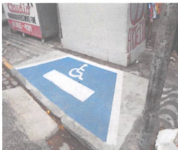
Figura 10: CONEXÃO INTERROMPIDA, nesta foto, a conexão foi bem-feita, mas uma barraca interdita o fim do percurso pela rampa do outro lado do sinal.
