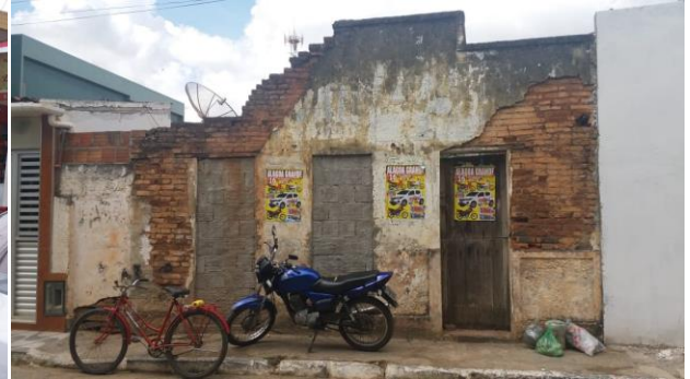
Figura 12 – Prédio em Ruínas na Rua Mestre Raimundo, Alagoinha/PB.
