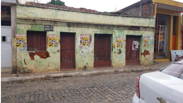
Figura 11 - Prédio em Ruínas próximo a Praça Geraldo Beltrão, Alagoinha/PB.
