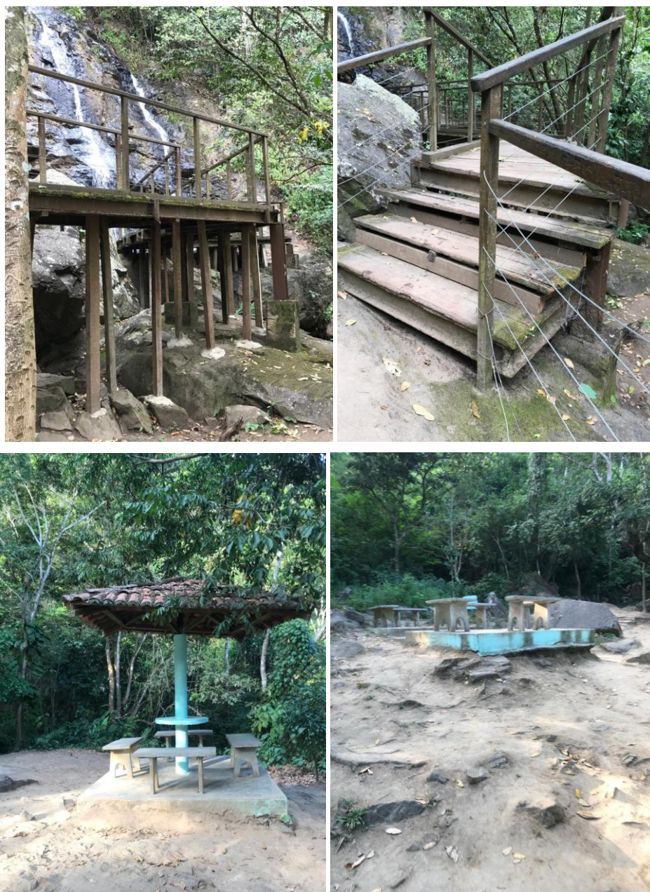
Figura 36: Problemas de infraestrutura no acesso a Cachoeira da Bica Grande
