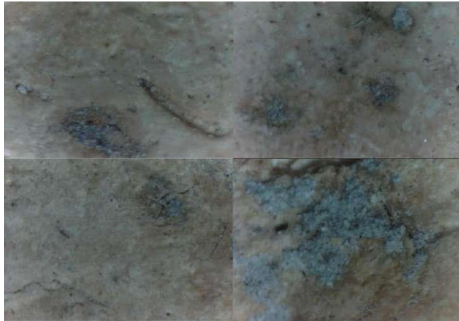
Figura 88 – presença interna de fungo.
