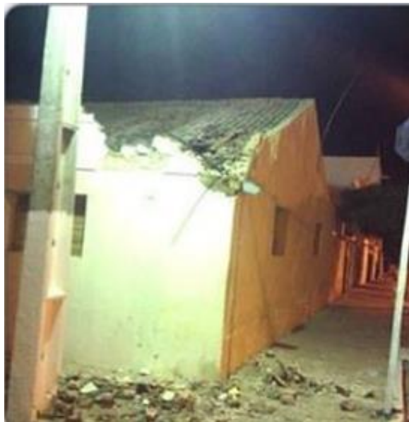
Figura 2. Casa de morador atingida por artefatos da explosão
