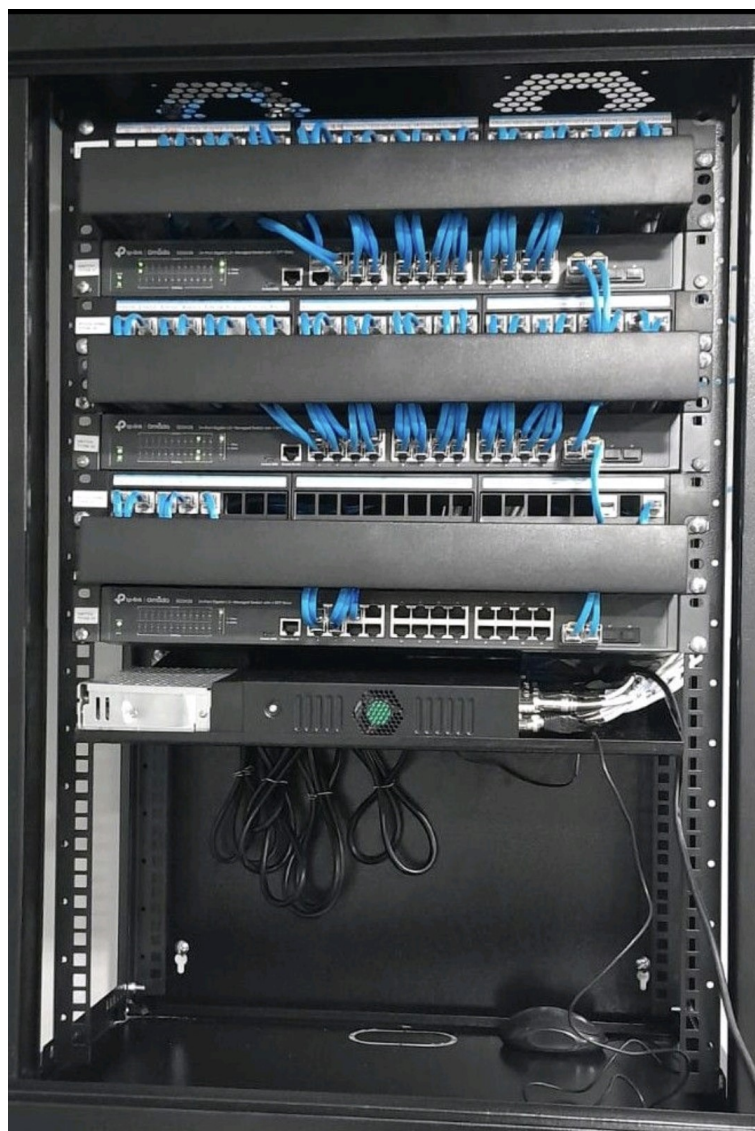
Figura 4 – Rack de redes
