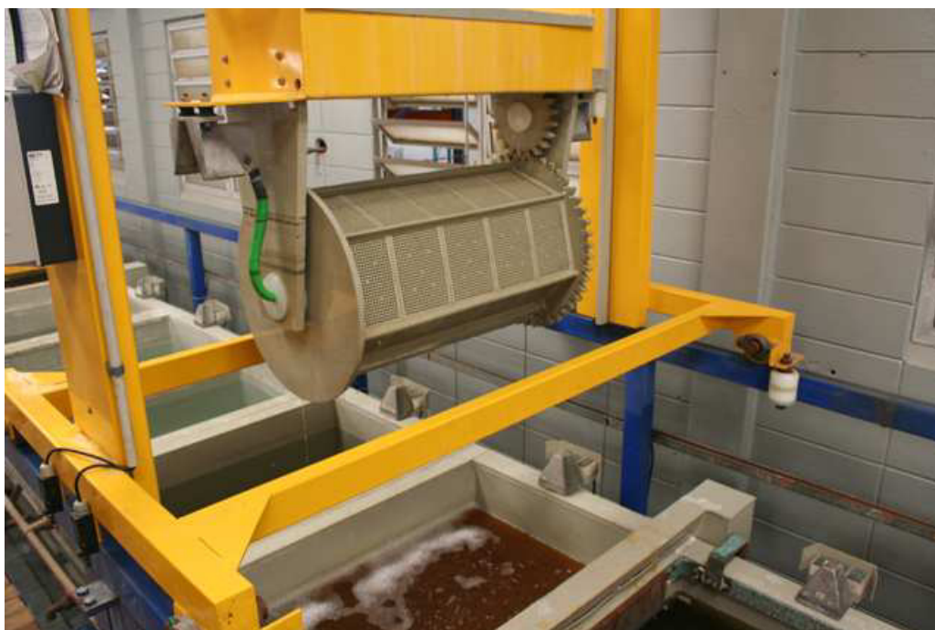
Figura 4 - Maquinário de banho de Zinco com cestos rotativos em operação.
