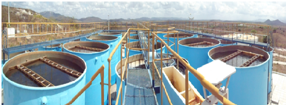
Figura 06-Vista geral da estação de tratamento de água - ETA de Itatuba. Fonte: Guimarães, H. R.C. 2012.
