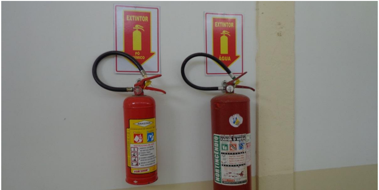
Figura 5 - Sistema de combate a incêndios
