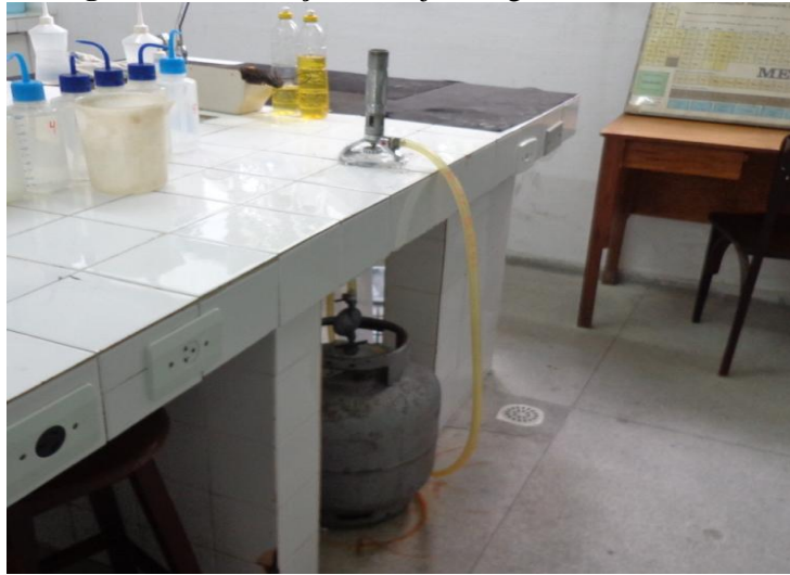
Figura 10 - Presença de botijão de gás no laboratório.
