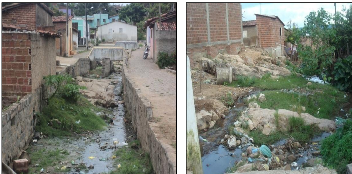
Fotos 19 e 20: Galeria do bairro dos Tanques, que recebe resíduos das residências e deságua no rio Jacu em São José do Campestre-RN.
