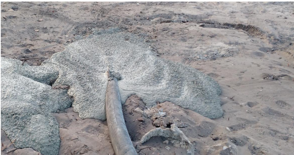
Figura 36 – Mangote estourado devido a entupimento.
