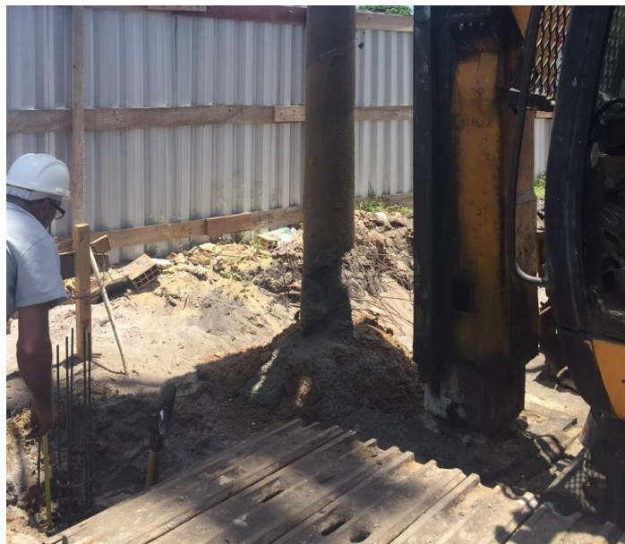
Figura 31 – Aglomerado de solo formado pela escavação e esborro do concreto Fonte: Registro de execução do VDR
