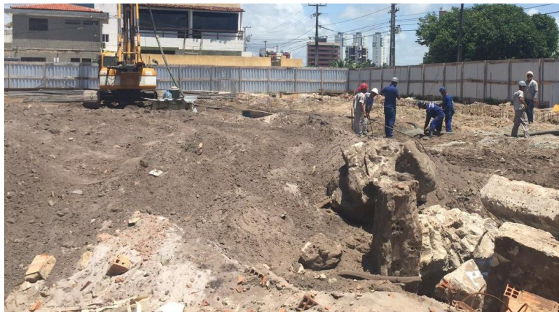
Figura 34 – Canteiro com excesso de areia escavada e materiais Fonte: Registro de execução VDR
