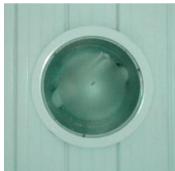
Figura 24- Luminária instalada nos corredores 1 e 2.
