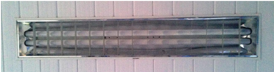
Figura 23- Luminária instalada nas salas tipo 1 e 2.
