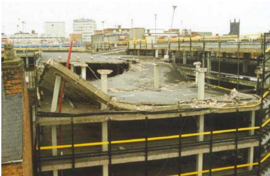
Figura 1- Colapso parcial do edifício Pipers Row Park em 25/03/1997
