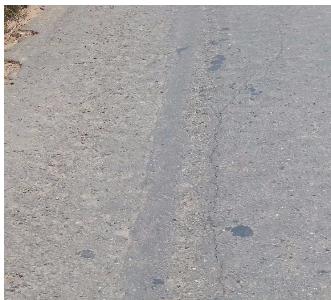
Figura 06: Desgaste e Trinca Longitudinal
