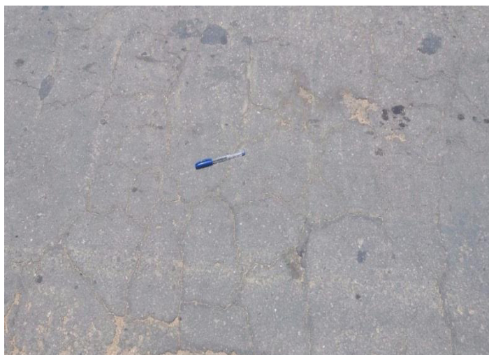
Figura 05: Trincas interligadas tipo “couro de jacaré”
