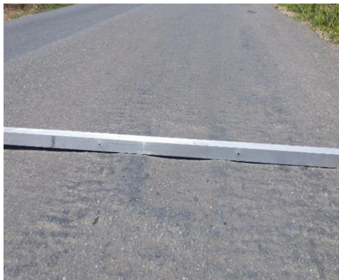
Figura 09: Afundamento local plástico
