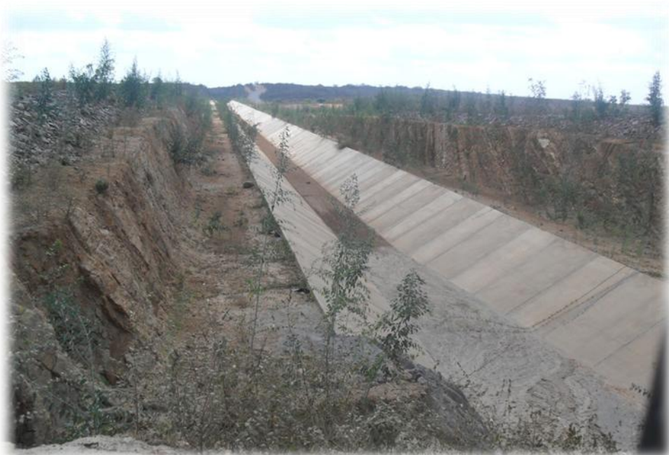
Fotografia 24: Canal da transposição em Salgueiro/PE. Assim como em Souza, as obras estão paradas e sem previsão para conclusão. Enquanto o dinheiro público é gasto de forma incorreta, muitas famílias sofrem com a falta d'água e sua má distribuição. Fonte: Trabalho de campo, 2011.
