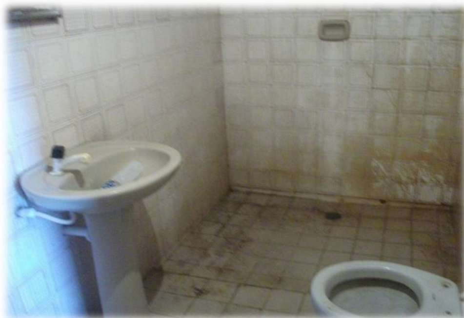
Fotografia 22: Banheiro em péssimas condições de uso em assentamento de reforma agrária na Paraíba. O banheiro usado pelos moradores não oferece condições de higiene e a água é transportada em baldes ou liberada diretamente da caixa d'água através de um cano. Souza/PB.
