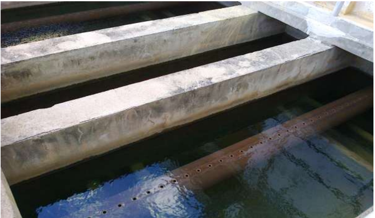
Fig.20 – Filtro de areia na ETA, Cacimba de Dentro – PB. Foto: Carlos Antonio de Lima, dez. 2013.
