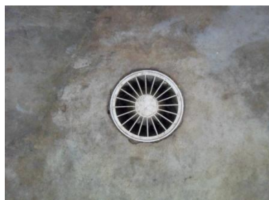
Figura 3 - Ralo da cantina da Escola do Município de Ferreiros – PE.
