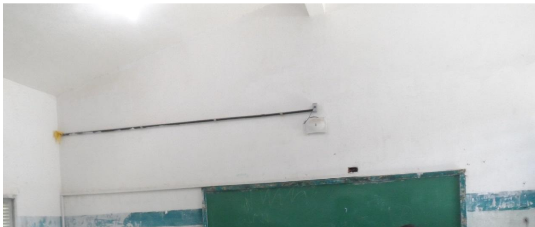
Foto 2: Modem instalado na sala de aula
