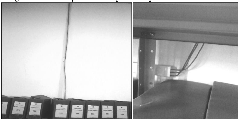
Figura 22 - 23 - Fiação elétrica exposta - Arquivo 1º andar.
