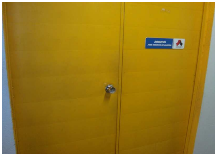
Foto 11: Porta corta fogo.
