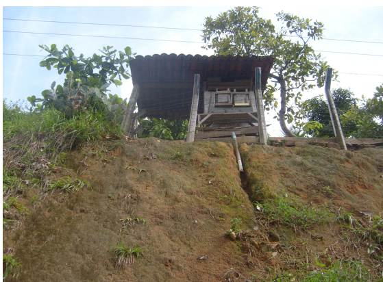
FIGURA 5 -Tubulação erodindo a encosta. Fonte: Paulo Gregório, 2008.
