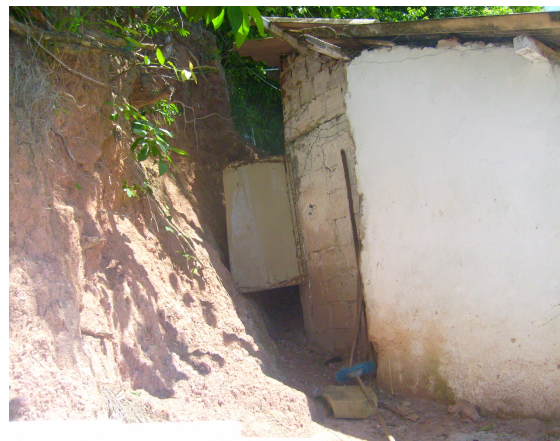
FIGURA 8- Casa em setor de alto risco.
