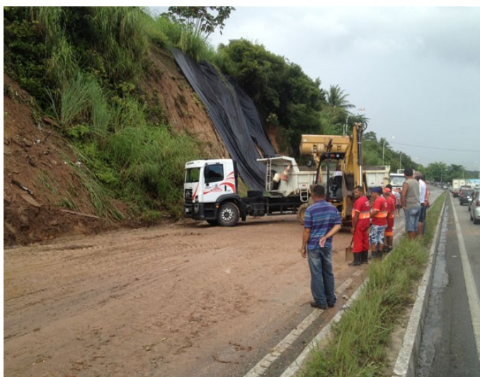
FIGURA 2- Deslizamento em talude as margens da rodovia federal BR230, sentido João Pessoa a Cabedelo. Fonte: Walter Paparazzo/G1, 2013.
