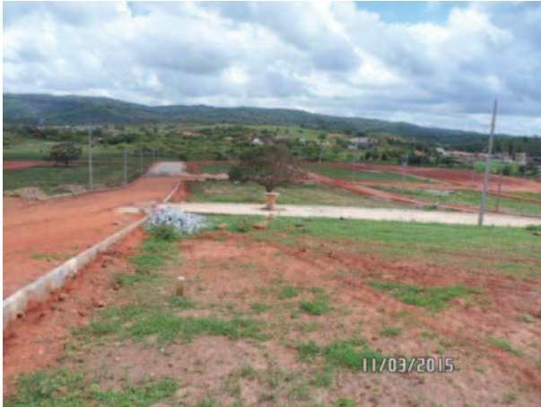
Fig.16 a 18: Fotos demonstrando a execução das obras de infraestrutura básica: limpeza do terreno, abertura e pavimentação das vias de circulação e implantação de meio-fio do loteamento. (Fotos: Isabela Bezerra da Costa Paiva, 2015).
