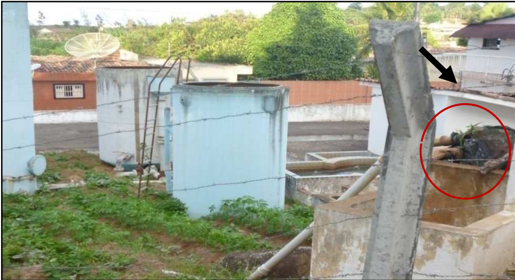
Figura 19: Estação de tratamento de água
