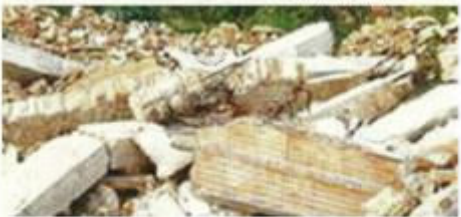
Restos de construção.
