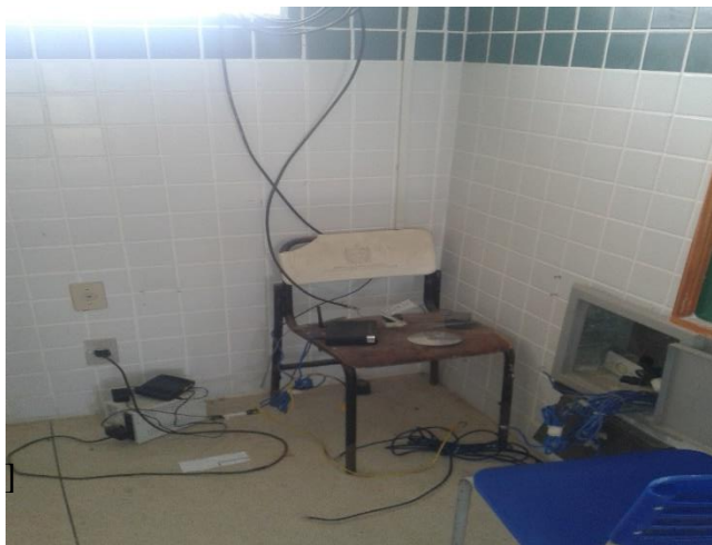
Figura 4: Fonte de energia dos computadores do laboratório
