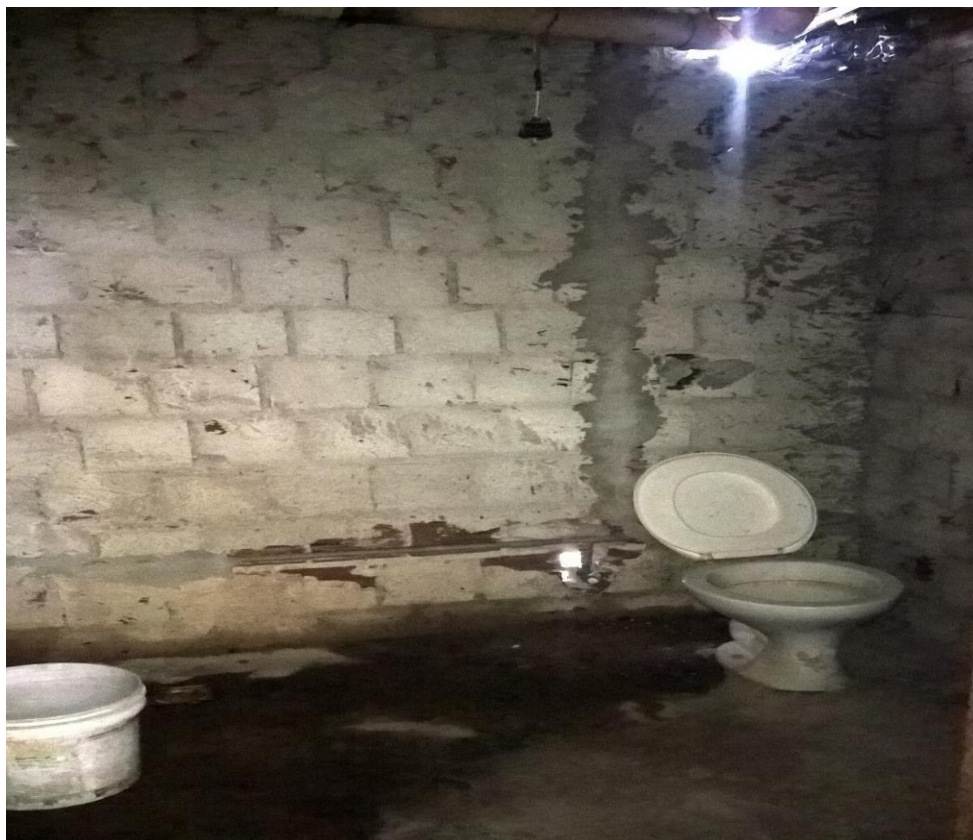
Figura 9. Banheiro instalado no galpão da ACATAVALE, não possui água encanada ou energia elétrica, é utilizado de forma precária pelos associados e pelos alunos do Projeto Sal da Terra. Fonte: ROCHA, N. R.O.
