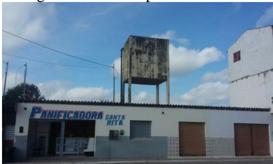
Figura 7: Reservatório Santo Antônio, Cuitegi/PB/2017 - Capacidade 50mil litros
