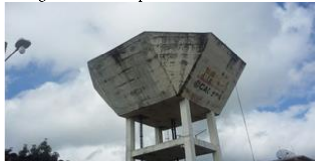
Figura 8: Reservatório do cruzeiro, Cuitegi/PB/2017 - capacidade 200mil litros
