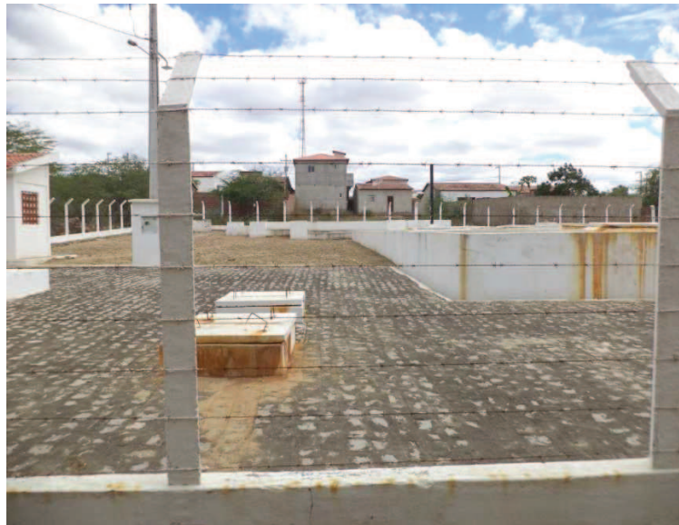
Figura 07 – Vista parcial da rede de coleta de esgotos da cidade de Olivedos-PB.
