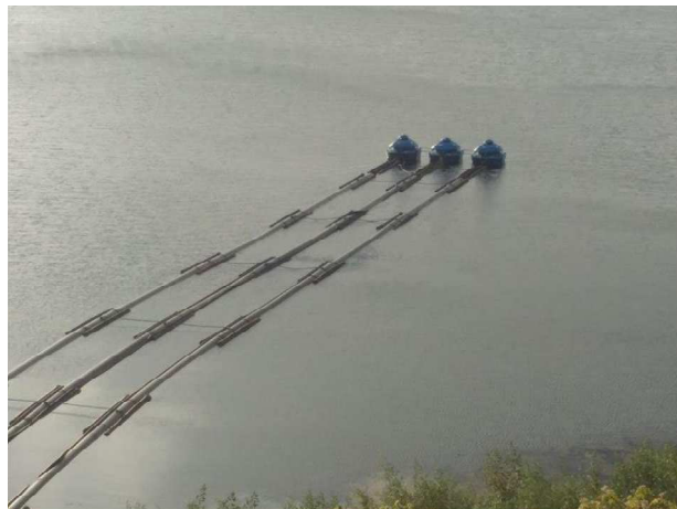
Figura 14: Bombas de captação de água flutuantes
