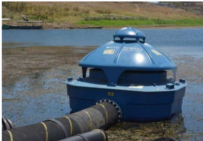
Figura 8 - Bomba de Captação do Açude Epitácio Pessoa.
