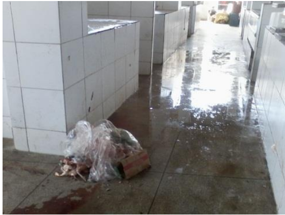
Figura 08 – Acúmulo de água suja e restos de carne Fonte: Arquivo Pessoal, 2016
