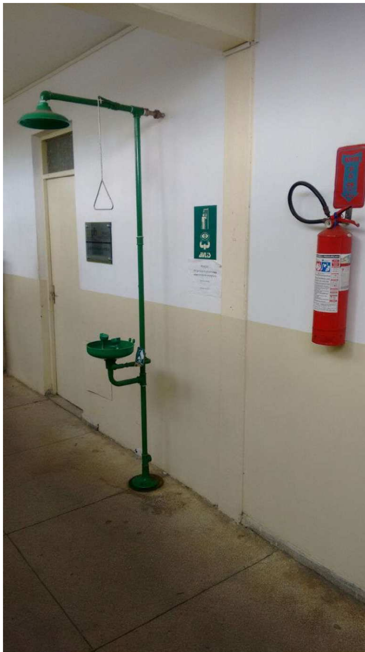
Figura 26 – Chuveiros e extintores presentes no bloco 1 (A) do CCT.
