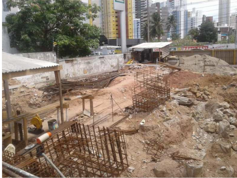
Figura 2 – Canteiro de obras congestionado
