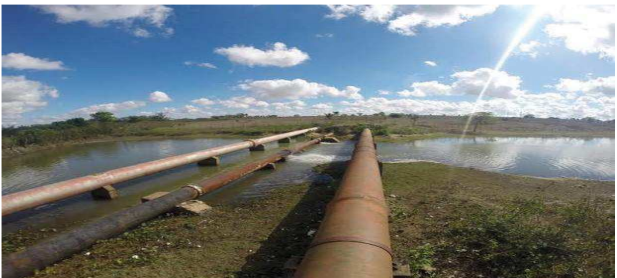
Figura: 08 Imagem do vazamento de água na adutora em Campina Grande.
