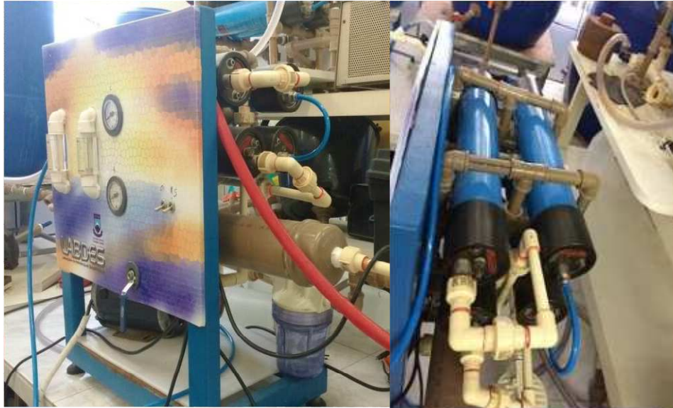
Figura 5 Sistema de Osmose Inversa
