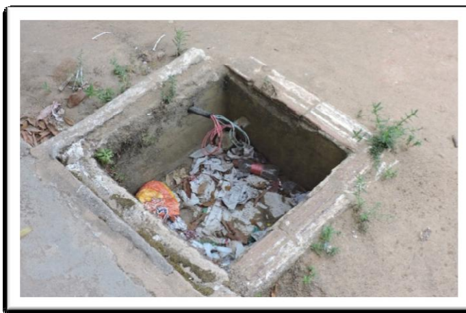
IMAGEM 2: REDE DE FIAÇÃO ELÉTRICA
